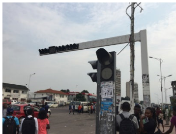
Broken traffic signals on 30 Juin Bld.
